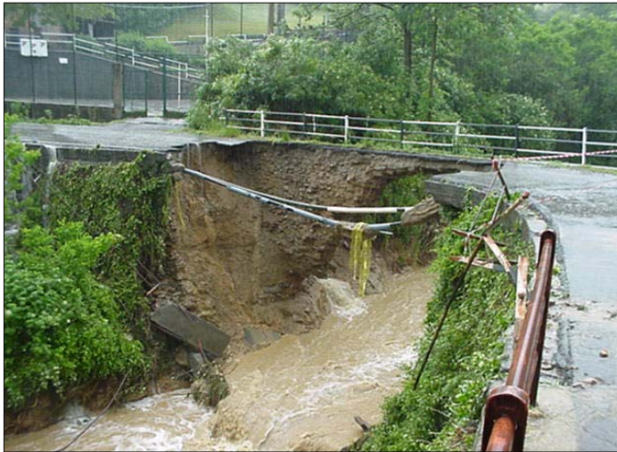
Fig.8. Comune di Netro: il ponte distrutto dalla piena del rio Ara.
